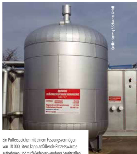
Mithilfe eines Rauchgaswärmetauschers kann Wärmeenergie, die ansonsten ungenutzt bleiben würde, über den Wärmeträger Wasser für Produktionszwecke teilweise wiederverwendet werden
